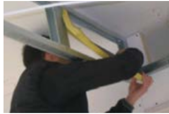
Colocación aislante lana de vidrio semirrígido (velo negro por lado interior imperativamente)
