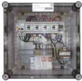
Coffret de désenfumage parking habitat collectif
