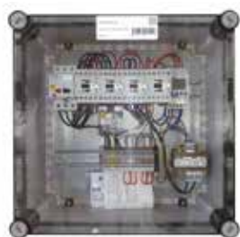
Coffret de désenfumage parking habitat collectif
