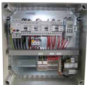
Coffret de désenfumage habitat collectif
