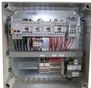
Coffret de désenfumage habitat collectif
