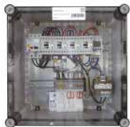
Coffret de désenfumage parking habitat collectif
